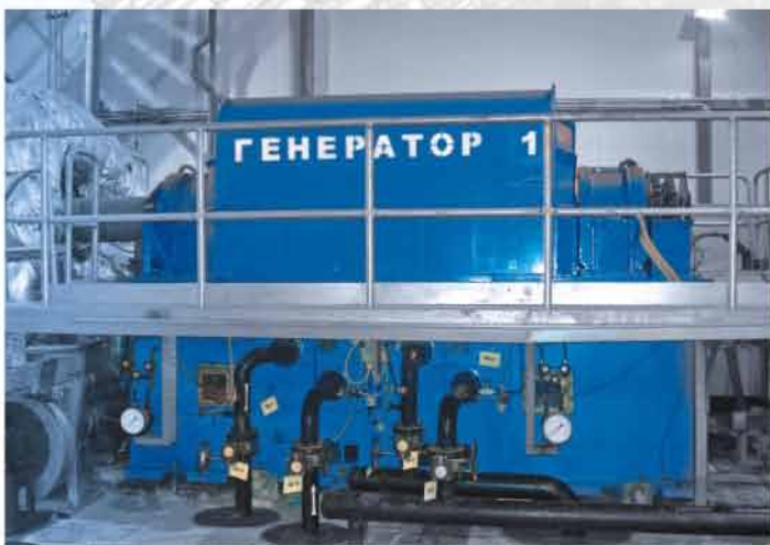
Турбогенератор ТФЭ-10-2(3x2)/6000 на магнитных подшипниках 10000 кВт, 3 кВ, 6000 об/мин.
